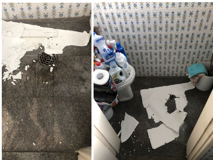
Detalhe massa corrida e tinta descoladas do teto banheiro do apto. nº 151 devido infiltração
