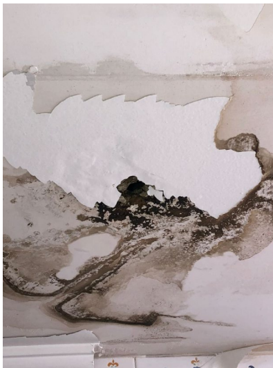
Detalhe teto banheiro apto. nº 151 Edifício Itassugui Mancha de mofo/Sinal da infiltração
