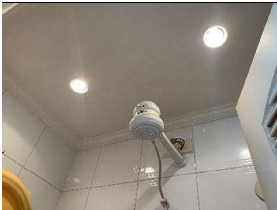
Foto 11. Detalhe do teto do banheiro de empregada.
