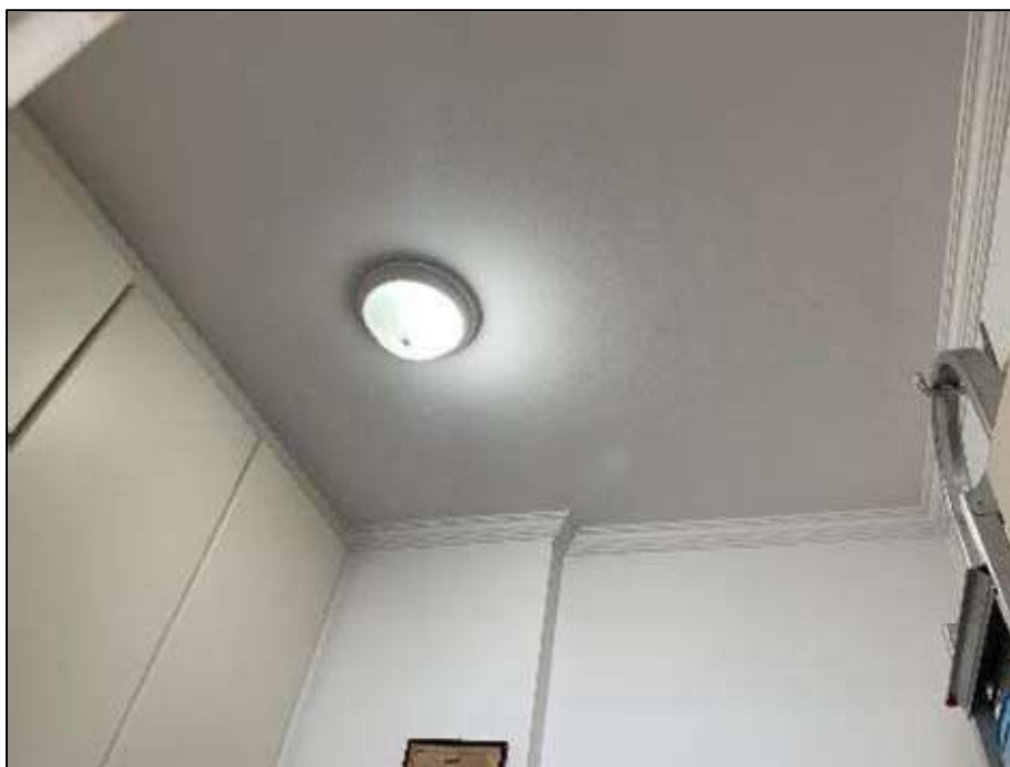
Foto 13. Detalhe do teto da dependência de empregada.
